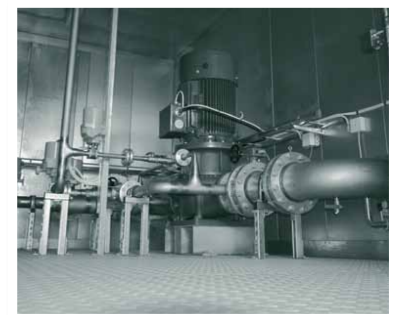
Ovan ser vi hur skummet sprutas på och under lastbilen. Systemet i skumcontainern består bl a av tryckhöjningspump och skumdoseringsystem. Samtliga rör av syrafast stål.
