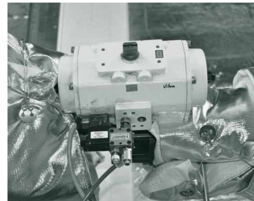
Drifttekniker Sören Eckerman löste problemet med ångregleringen på ett smart sätt.
